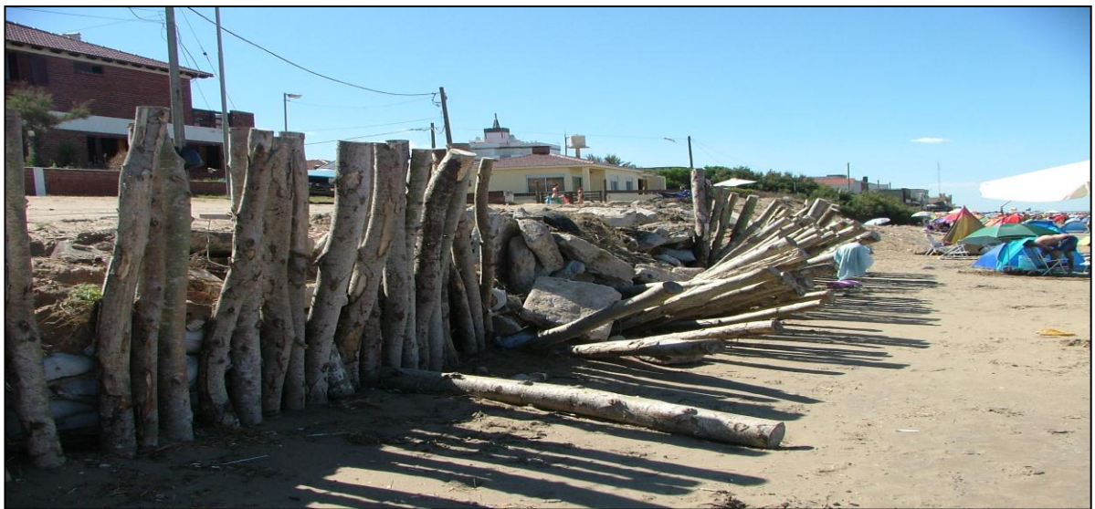
Figura 48: Mar de Tuýu 2008 destrucción de sistema de defensa precario. Vista hacia el norte. Fuente Ruth Maricel Trus
