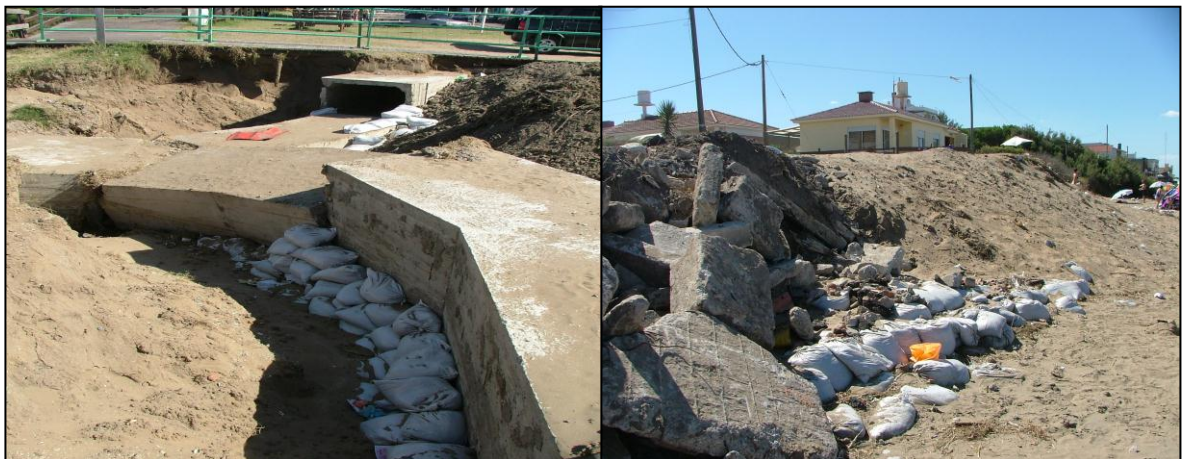
Figura 49: destrucción de sistema dedesagüe e improvisación de defensa con bolsas de arena. Mar del Tuyú 2008. Fuente Ruth Maricel Trus
