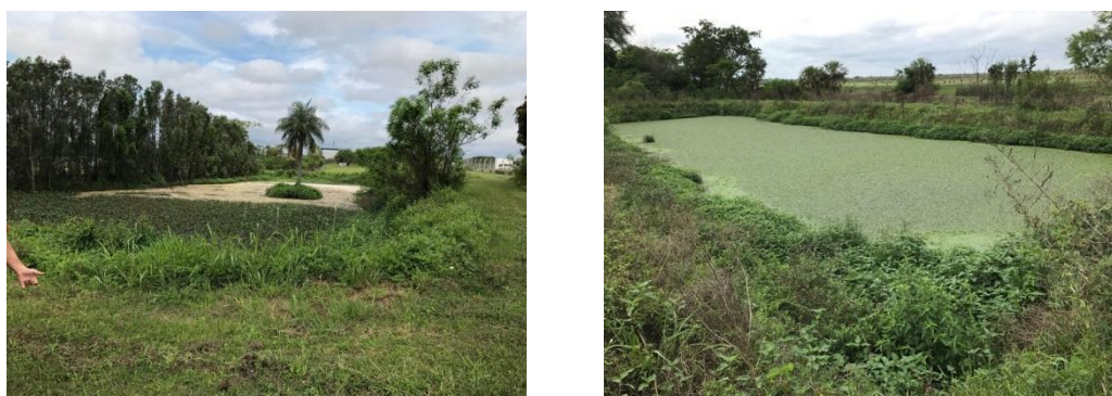
Figura 10: Piletas de decantación para el tratamiento de efluentes, a la izquierda pileta de tratamiento anaeróbico y a la derecha está la pileta de tratamiento aeróbico
