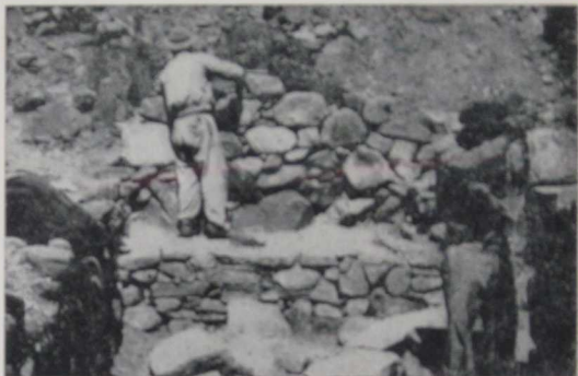
Construcción de las paredes y gradas de piedra de una de las viviendas.
