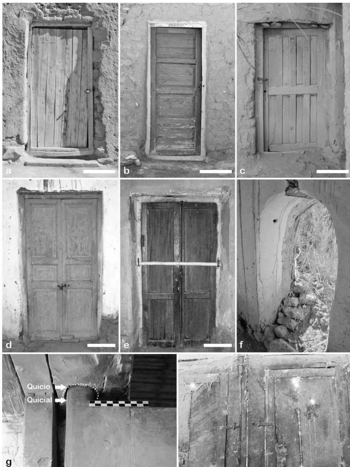
Figura 6.2.27. Tipos de puertas identificados y detalles: a. Puerta de una hoja armada con listones, b y c. Puerta de una hoja armada con cuarterones, d. Puerta de dos hojas con cuarterones, e. Vista interior de puerta de dos hojas con cuarterones, f. Vano de puerta con arco de medio punto, g. Detalle de sistema de apertura con quicial e i. Puerta con ventanas de cuarterones. Barra: 50 cm. Fuente: Elaboración propia.
