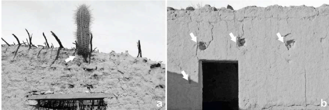
Figura 3.3.15. a. Biodeterioro potencial por crecimiento de plantas. b. Deterioro por sustracción de elementos constructivos, en este caso se observa los huecos de las vigas de la galería sustraídas.
