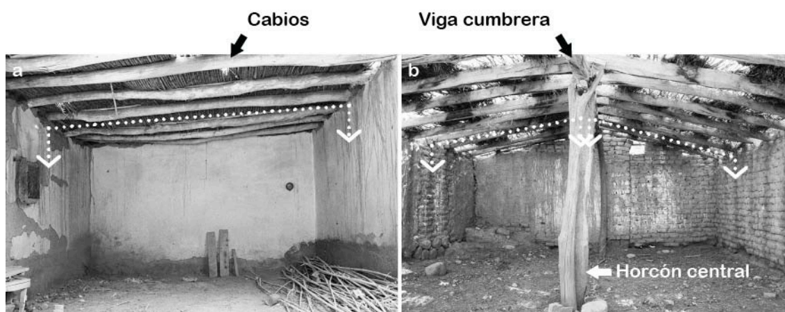
Figura 6.2.19. a. Techo a un agua, b. Techo a dos aguas. Las líneas punteadas indican la forma de descarga de los cabios. Fuente: Elaboración propia.
