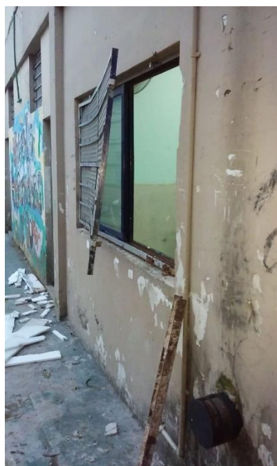
Imagen # 40: Fotografía de ventana forzada tras robo
