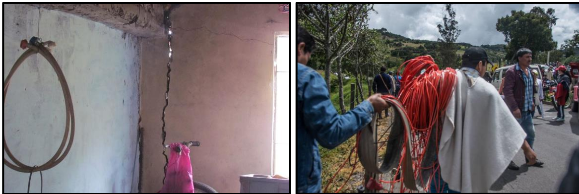
Figura N° 50: Agrietamientos en casas y remoción de cables por las tareas de exploración sísmica. Fuente: Colectivo por la Protección de la Provincia de Sugamuxi
