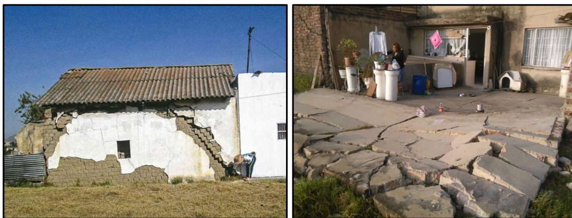
Figura N° 33: Agrietamientos en viviendas del barrio Asodea, ciudad de Sogamoso. Fuente: Revista Semana Sostenible y RCN Radio. http://bit.ly/2F8JkzW y http://bit.ly/2F81gdF
