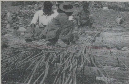
Sobre las vigas de cardón se dispone una capa de cañas atadas entre sí.
