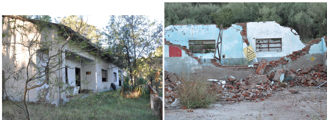
Figura 39a y 39b: Edificaciones abandonadas y en estado de demolición, algunas con señalización de “riesgo de derrumbe” que forman parte de las primeras instalaciones de la empresa en el lugar.
