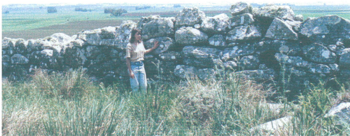
Figura 35. Detalle de la construcción de los muros pircados sobre la porción media del recinto (Estructura 1 corral).
