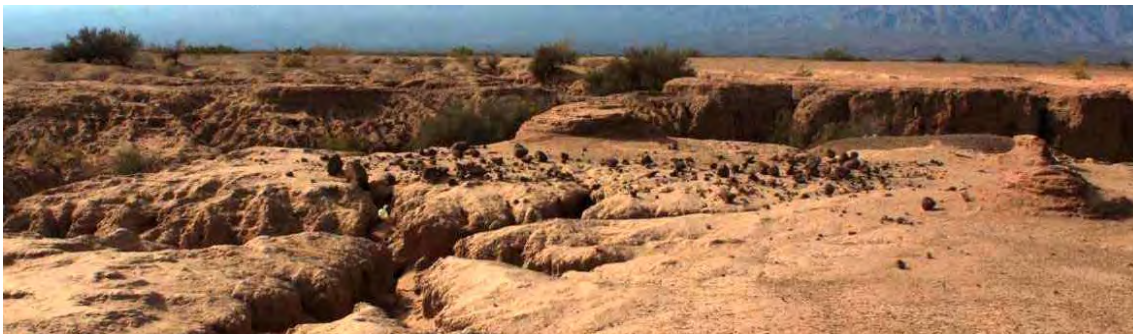
Figura 8.2. Vista del estado de conservación de la estructura R11 de Las Eras Viejas 25.
