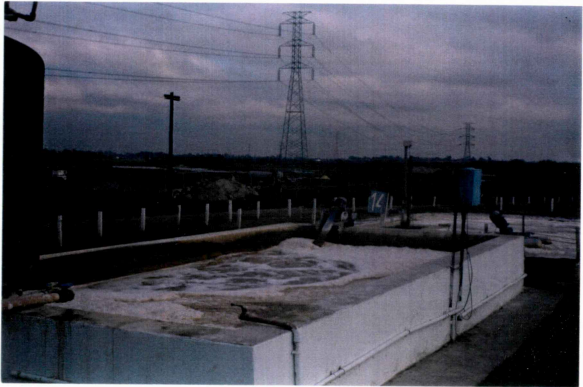
FOTO N° 13. CDF NORTE III. PLANTA DE TRATAMIENTO DE LIXIVIADOS
