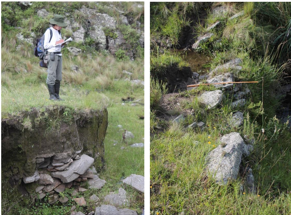
Figura 5.45. T297, donde puede verse el derrumbe del muro y el perfil expuesto. En la T 298, se puede ver el ancho del muro y la disposición de la mampostería
