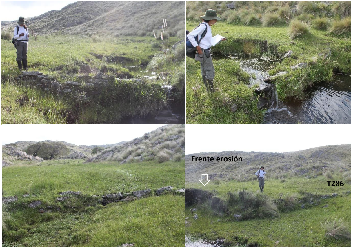
Figura 5.46. Distintos ejemplos de muros erosionados y emplazados en la quebrada 11
