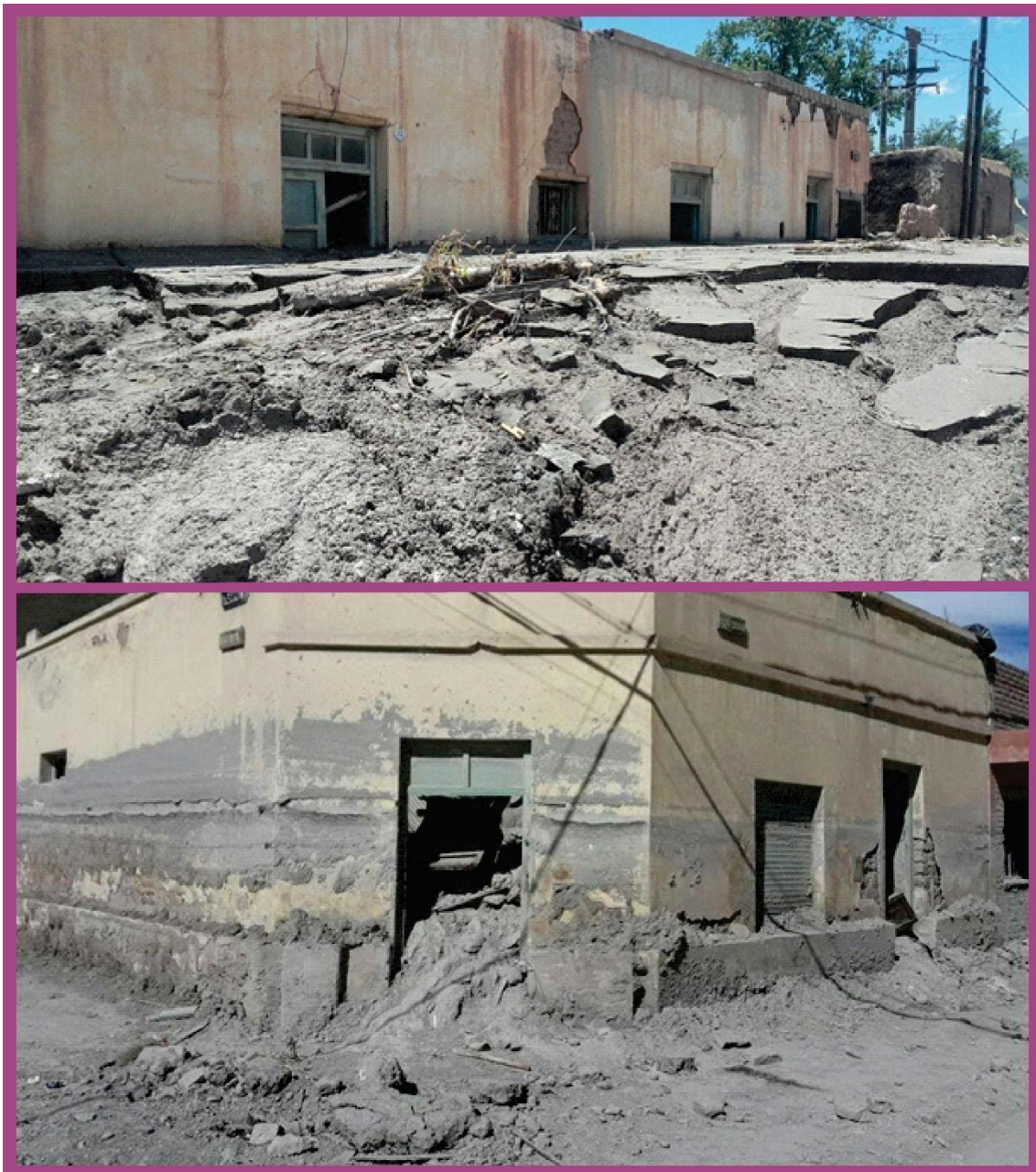
Figura 63. Daños materiales causados por los aluviones ocurridos en Volcán. Añô (2017). Fuente: Diario El Tribuno ( https://www.eltribuno.com/jujuy/nota/2017-12-20-17-34-0-volcan-el-pueblo-que-logro-sobreponerse )
