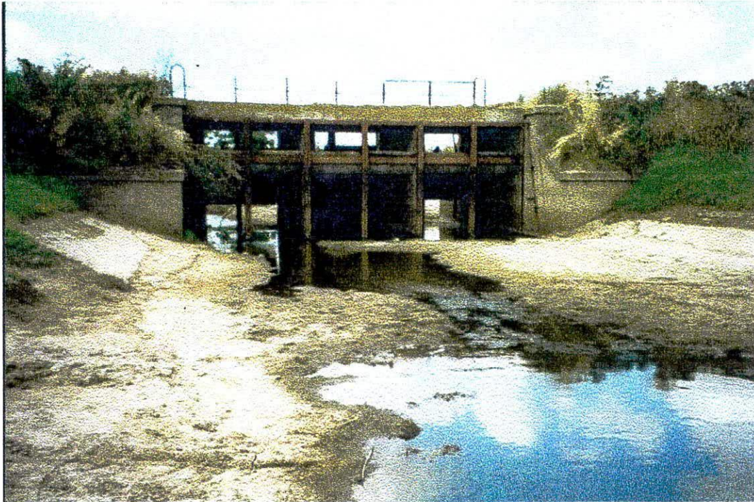
Figura 9.- Compuerta sobre el Canal Nº 5
