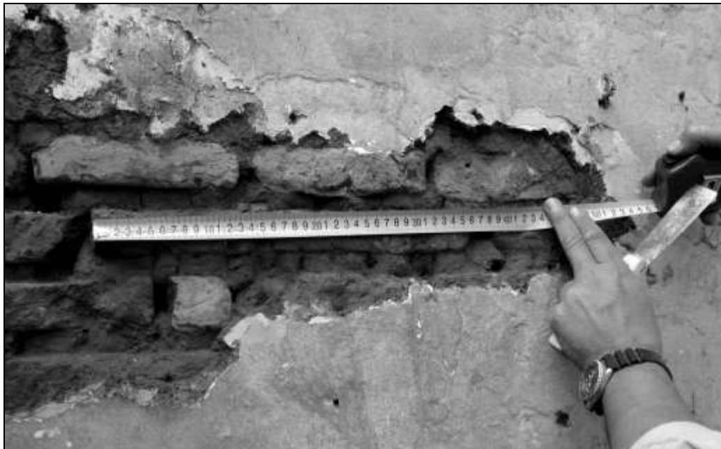
Figura 6. Detalle de la pared lateral sur, en el sector A2, donde puede observarse la presencia de adobes y ladrillos, y las sucesivas capas de cal y pintura
