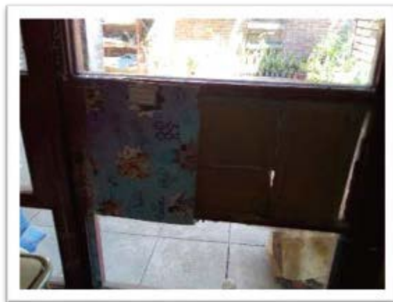
Fotografía 28. Registro fotográfico de una de las puertas del salón con los vidrios rotos
