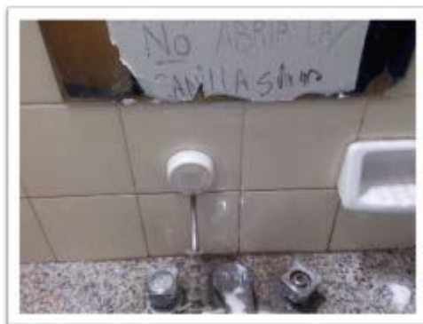
Fotografía 18. Registro del baño en planta baja de los docentes. "No abrir la canilla" es la indicación para que no se termine de romper y el baño se inunde.
